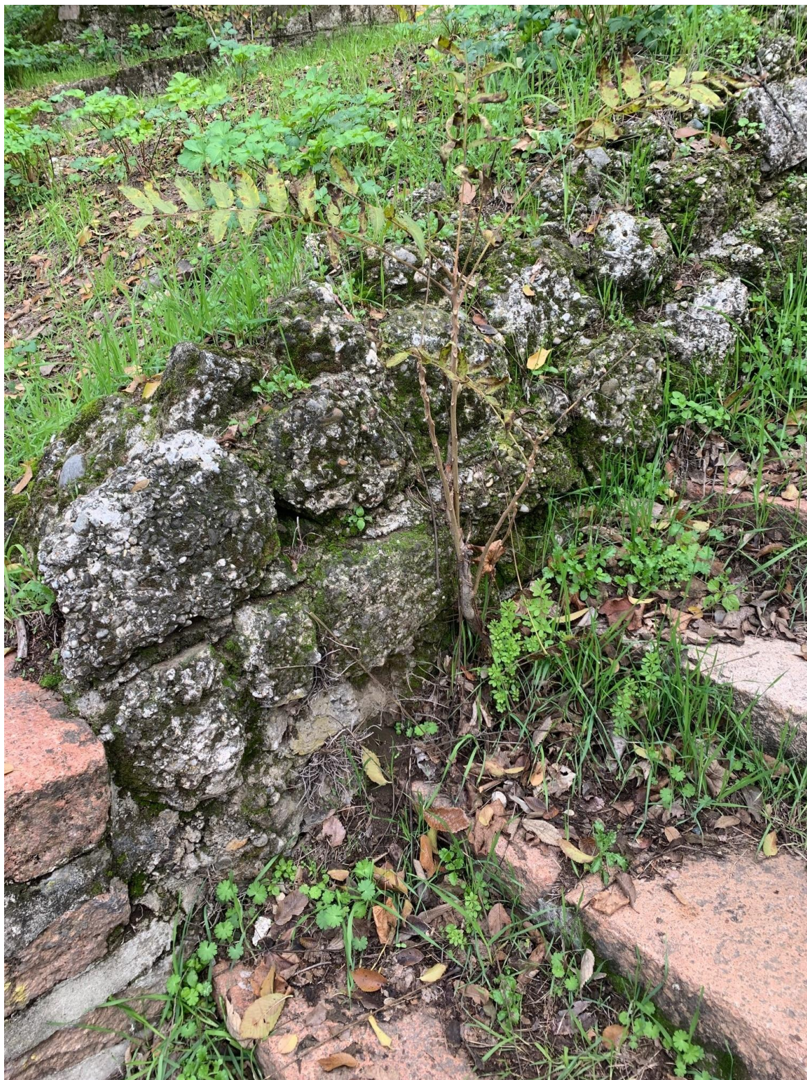
Ingresso carraio da via Terzaghi – giovane pianta di Ailanto nata tra un gradino e il muretto del lato sinistro della scala di pietra
